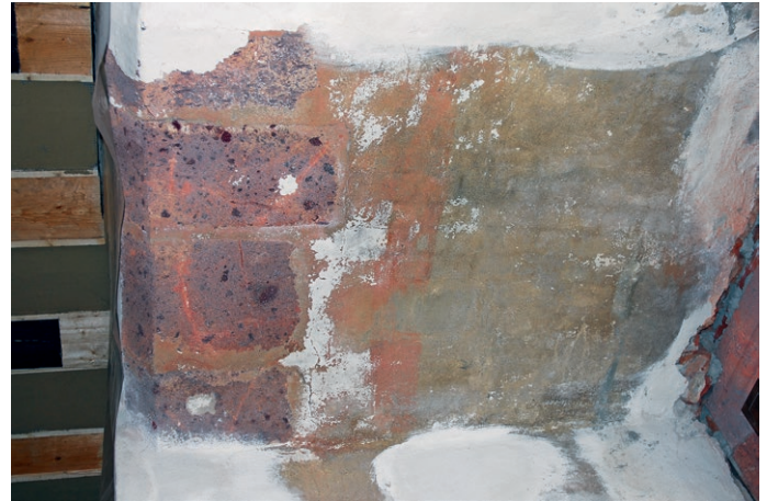
3 Freigelegter Befund der roten Quaderfassung von 1475, hier die Porphyrtuff-Werksteine überfassend und in Quadern auf dem Putz endend.
