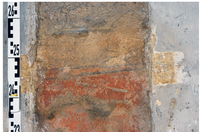
4 Befund der stark gealterten Quaderfassung mit linearer Vorzeichnung hinter der eingestellten Flurmauer an der Südwand.
